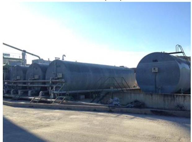
Instal·lacions auxiliars – Planta aglomerat 1
